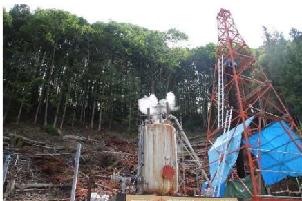
奥飛騨第1バイナリー発電所（地熱）
