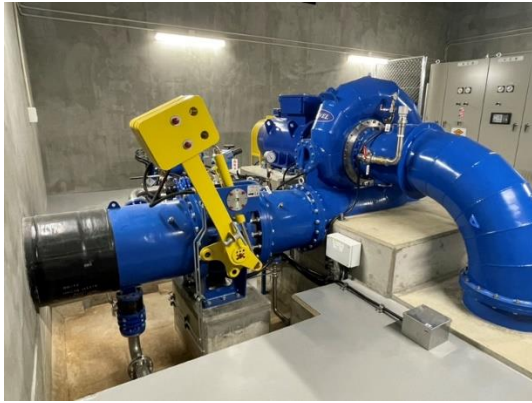
<チェコ製横軸フランシス水車と発電機（鶴の湯）>
