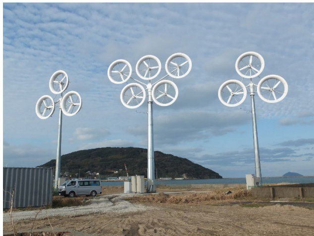
(左：9kW / 中央：15kW / 右：9kW)
